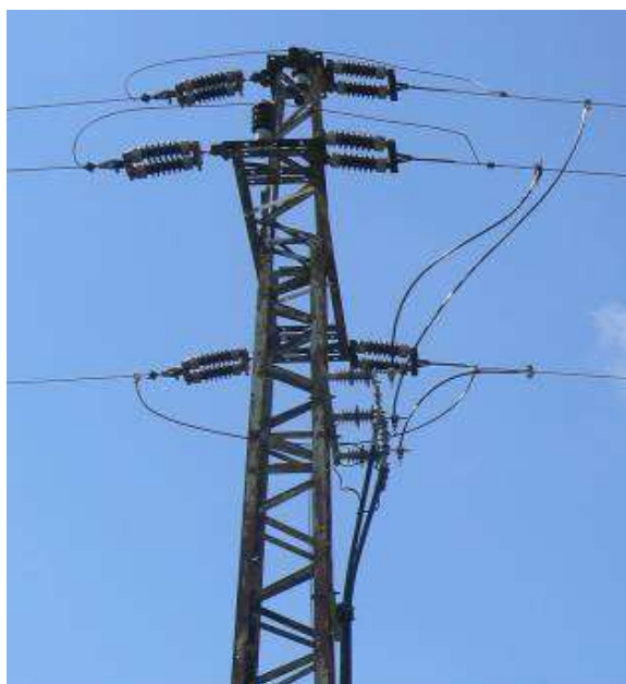
15. Kép 20 kV-os kábelindítás oszlopkapcsoló nélkül
