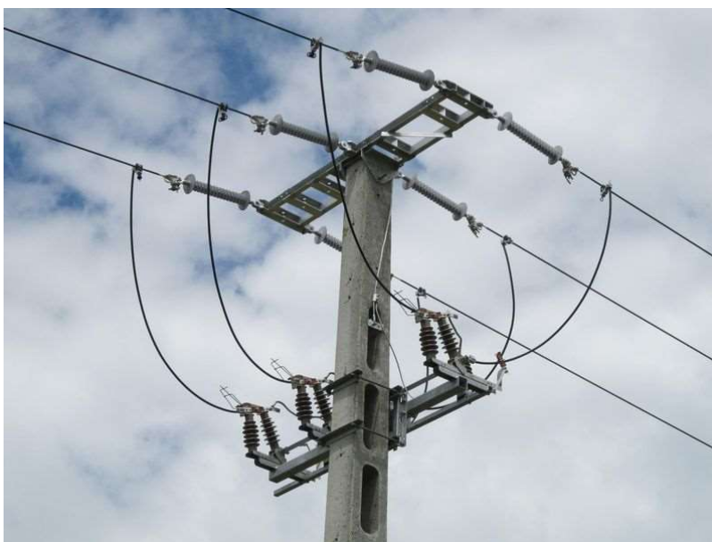
11. Kép Vonal alatti gerincbontó oszlopkapcsoló
