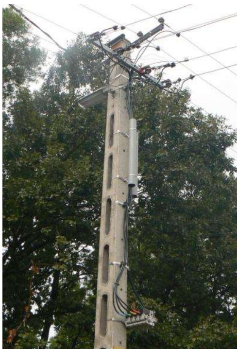
5. Kép KIF leszálló vezeték és oszlopkapcsoló
